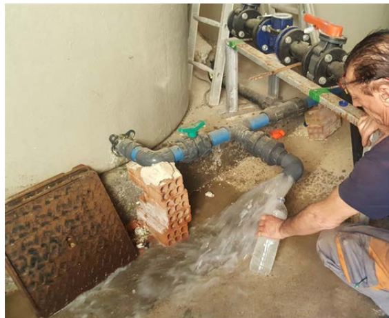
Figura 14. Recogida muestra de agua en el depósito al que se bombean las aguas procedentes del nuevo sondeo, y que desde ahí son distribuidas al balneario.
