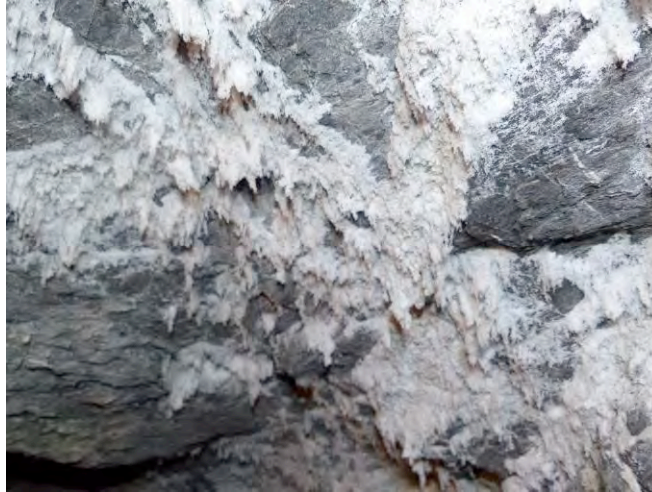
Figura 12. Eflorescencias de starkeyita en la galería de acceso a los sondeos del Balneario.
